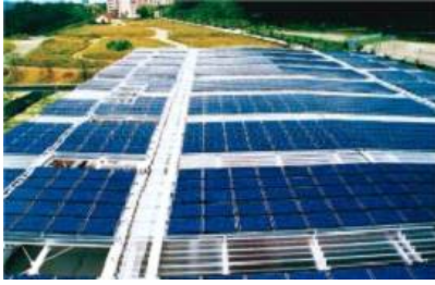
兵庫県西播磨総合庁舎太陽光発電システム
