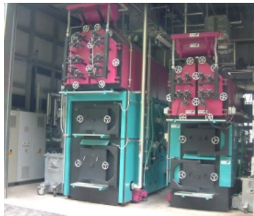
木質チップボイラーでCO2 排出抑制
